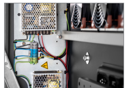
fachgerechte Verkabelung nach VDE
